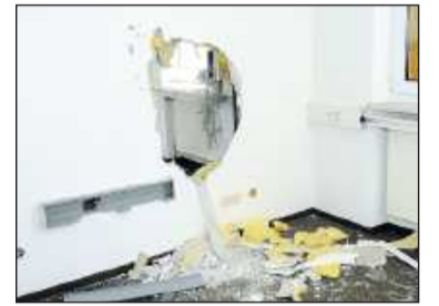
Durch die Wand: So haben sich Einbrecher ihren Weg in einen Raum gebahnt.
